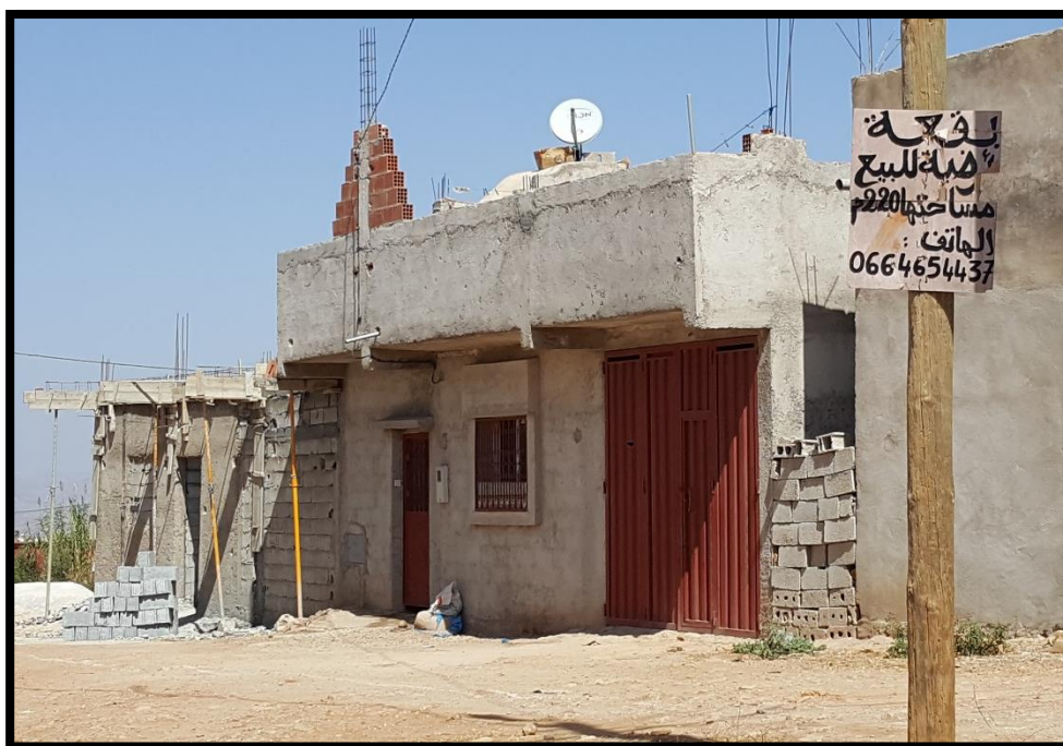
Photo 4 : Constructions non réglementaires au quartier Takaddoum
